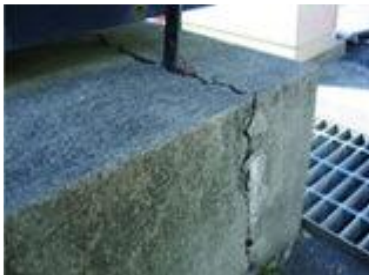
看板基礎部分のひび割れ
