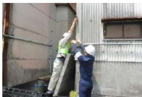
家屋被害認定〔2次調査（屋外）〕の様子
