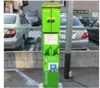
図 4 - 3 - 2 電気自動車の充電設備
